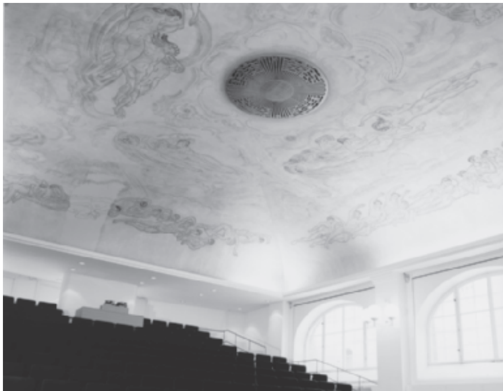
Fig. 2. Vy av Axel Törnemans takmålning "De elektriska strömmarna" sedan den 1993–1994 hade flyttats till en nyrenoverad lärosal på Kungl. Tekniska Högskolan. I fonden syns konturerna av den del som förstördes när en dörr togs upp genom takmålningen under 1950-talet i den lärosal där den hade utförts 1917. Foto: Tomas Asplund 1997.
